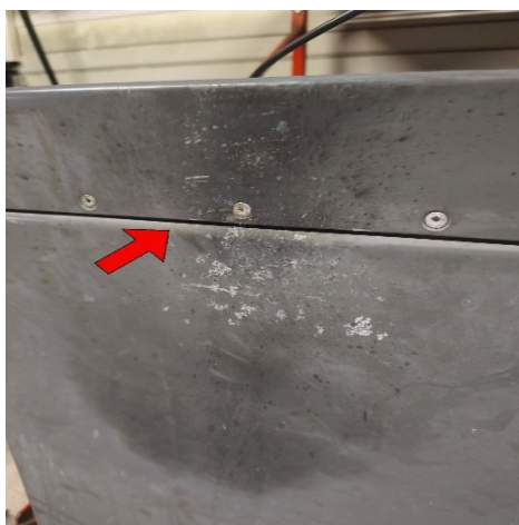
Foto 12_ Schmauchspuren durch entstandenen Kurzschluss
