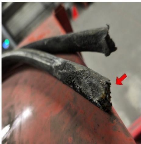
Foto 14_ Beschädigte Leitung durch Abscherung und Kurzschluss (2)
