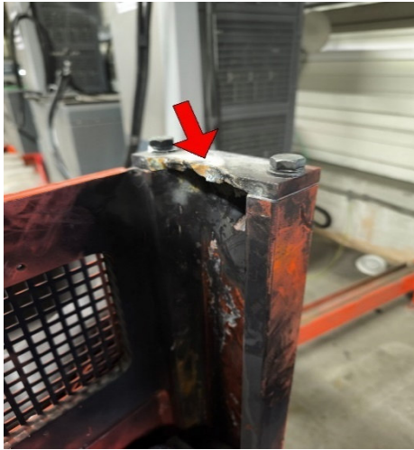
Foto 1_ Starke Schäden durch entstandenen Kurzschluß (1)
