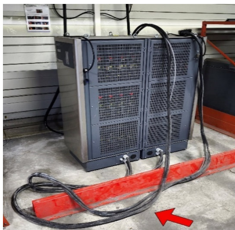
Foto 17 Fehlerhafte Leitungsführung am Ladegerät. Gefahr von Quetschen, Abscheren und überfahren der Batterieanschlußleitung.
