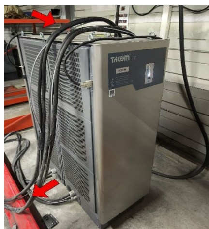
Foto 15_ Fehlerhafte Leitungsführung am Ladegerät.
