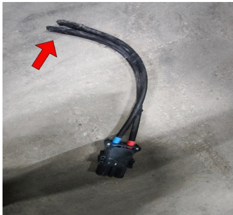
Foto 13_ Beschädigte Leitung durch Abscherung und Kurzschluss (1)
