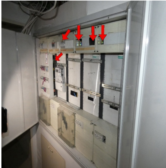
Foto 26 Keller Anschlußraum HV
